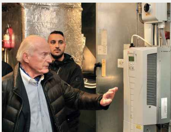
Her ser vi Christian Ringnes på jakt etter energytyver i Thorvald Meyers gate 2, Oslo. Bildet er fra teknisk rom hvor ventilasjonsanlegg besiktiges. Foto: Glen Widing, Estate Nyheter.
